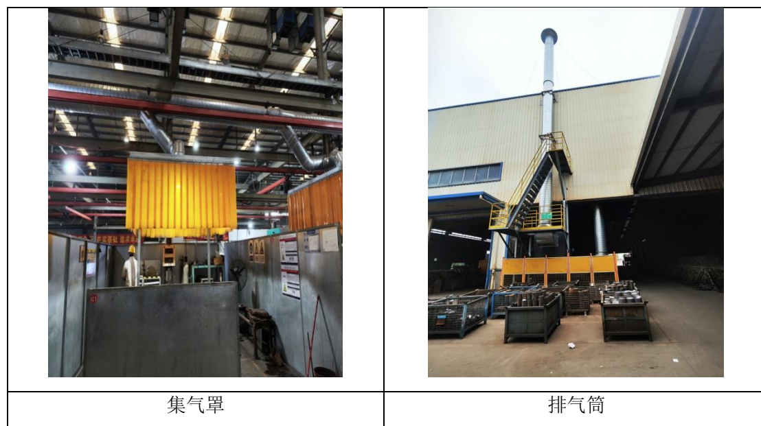
图3-12. 焊接废气处理设施现场图
