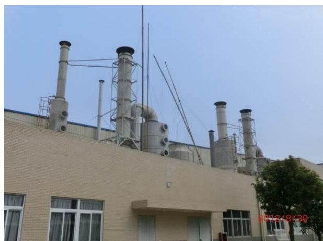
图3-9. 铬酸雾回收净化器+酸雾喷淋处理塔现场
