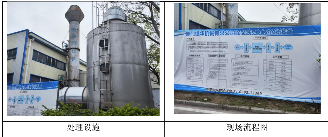
图3-11. 有机废气处理设施现场图
